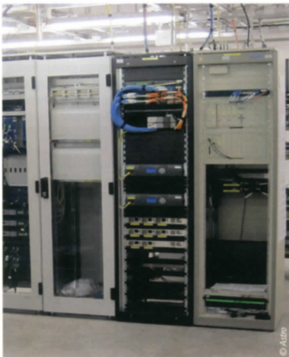
Headend installation at Kabel Deutschland
