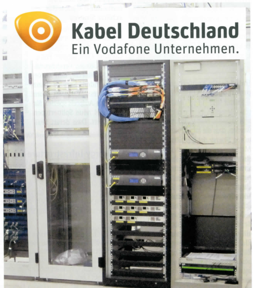
Headinstallation bei Kabel Deutschland
